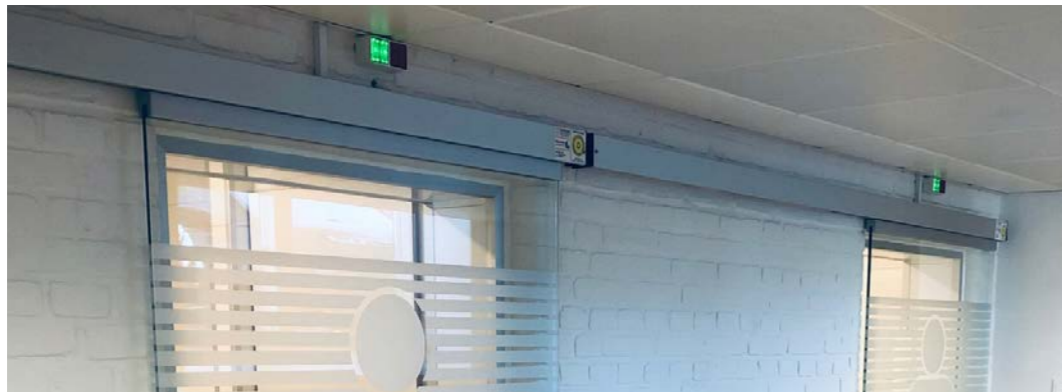
Lampe som lyser grønt når der er et eller flere ledige toiletter og rødt hvis alle toiletter er optaget.
